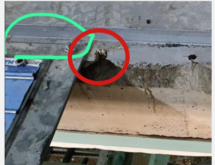
Сколы монтажного проёма
